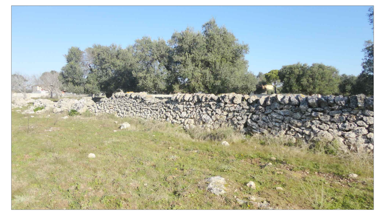
muro a secco da ricostruire nelle parti mancanti
