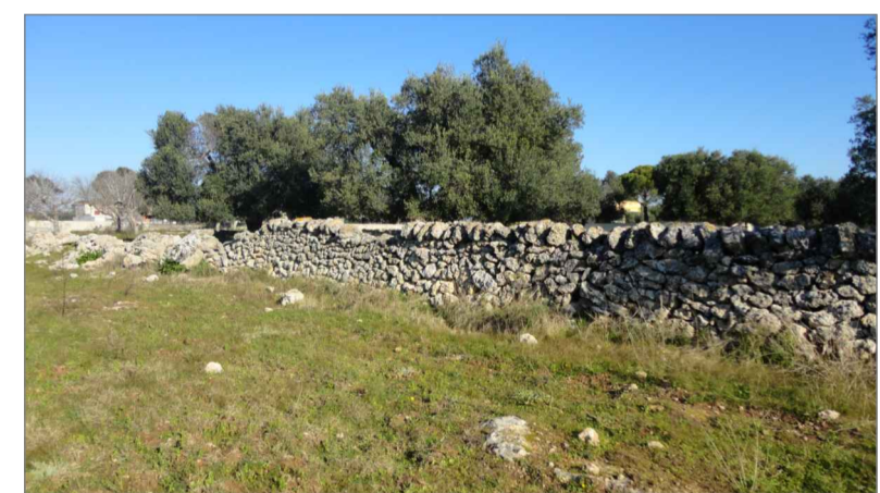
muro a secco da ricostruire nelle parti mancanti
